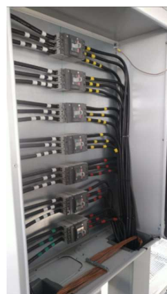
Fig. 9. Gabinete de ITM's de inversores.
