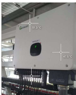
Fig. 7. Inversor en correcta operación.
